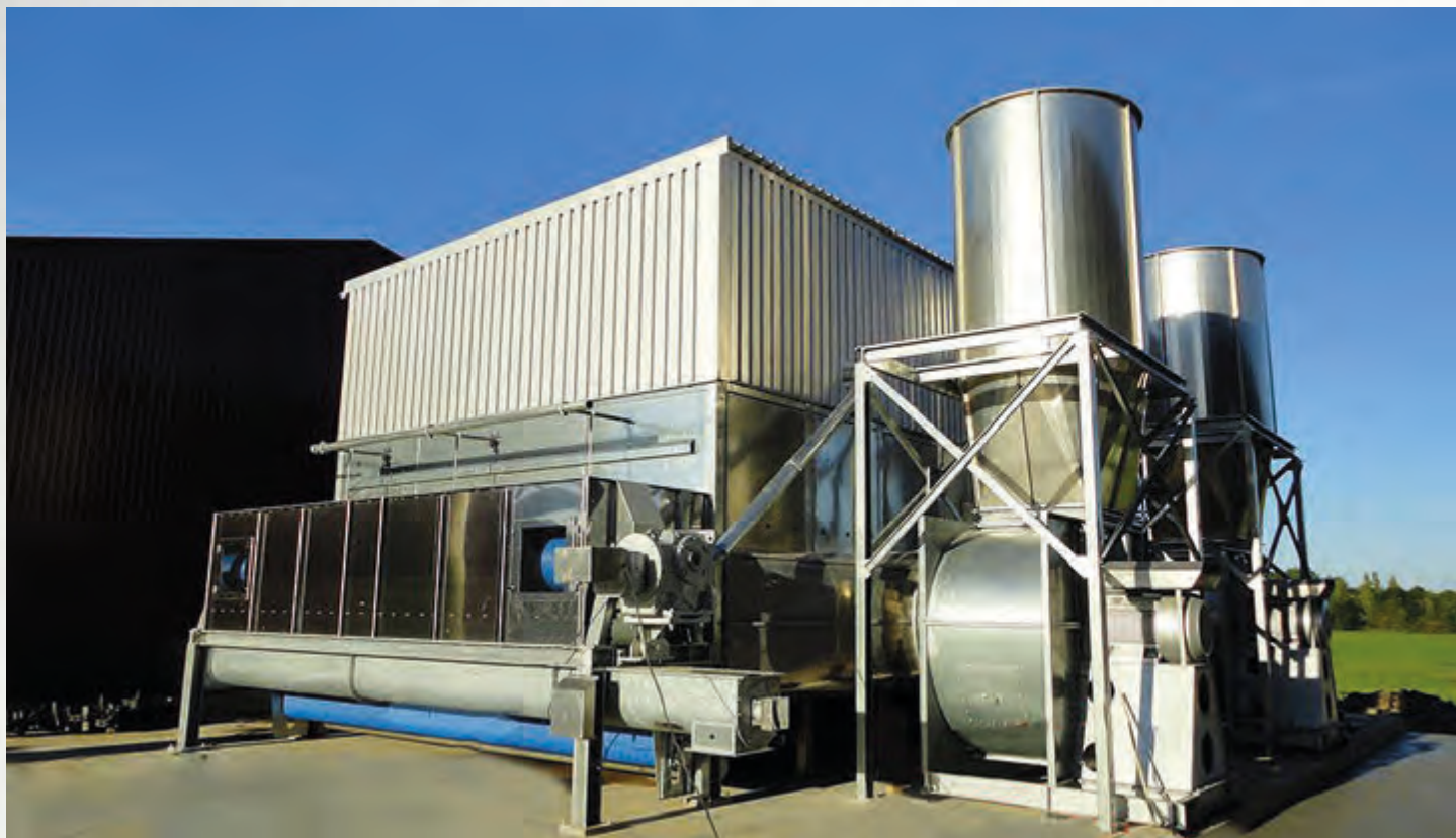
项目地：Kokopas trades Grupa, 拉脱维亚 | 型号：BT 1/6200-12 | 安装年份：2011 干燥物料：木屑 | 出料能力：约4.0吨/小时 | 降水区间：50% - 10%湿度
