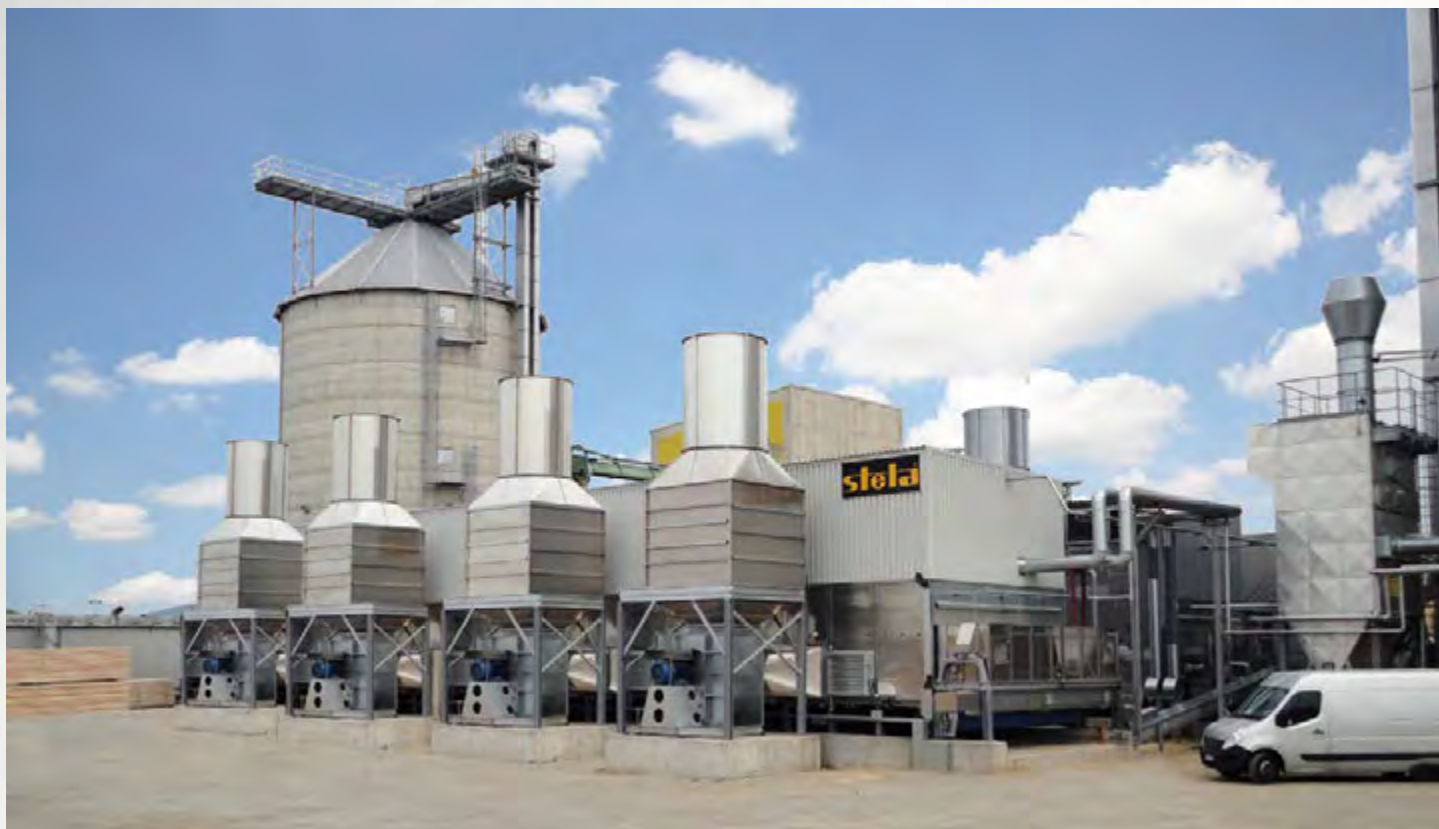
项目地：Sägewerk Schwaiger, 德国 | 型号：BT 1/6200-33 | 安装年份：2011 干燥物料：木屑 | 出料能力：约10.0吨/小时 | 降水区间：50% - 10%湿度
