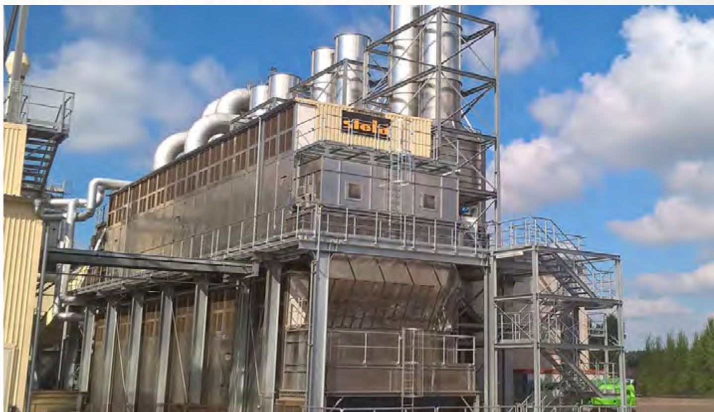
项目地：Kronoply GmbH, 德国 | 型号：BT 1/6200-25.5 | 安装年份：2016 干燥物料：OSB定向刨花板 | 出料能力：约48.6吨/小时 | 降水区间：53% - 42%湿度
