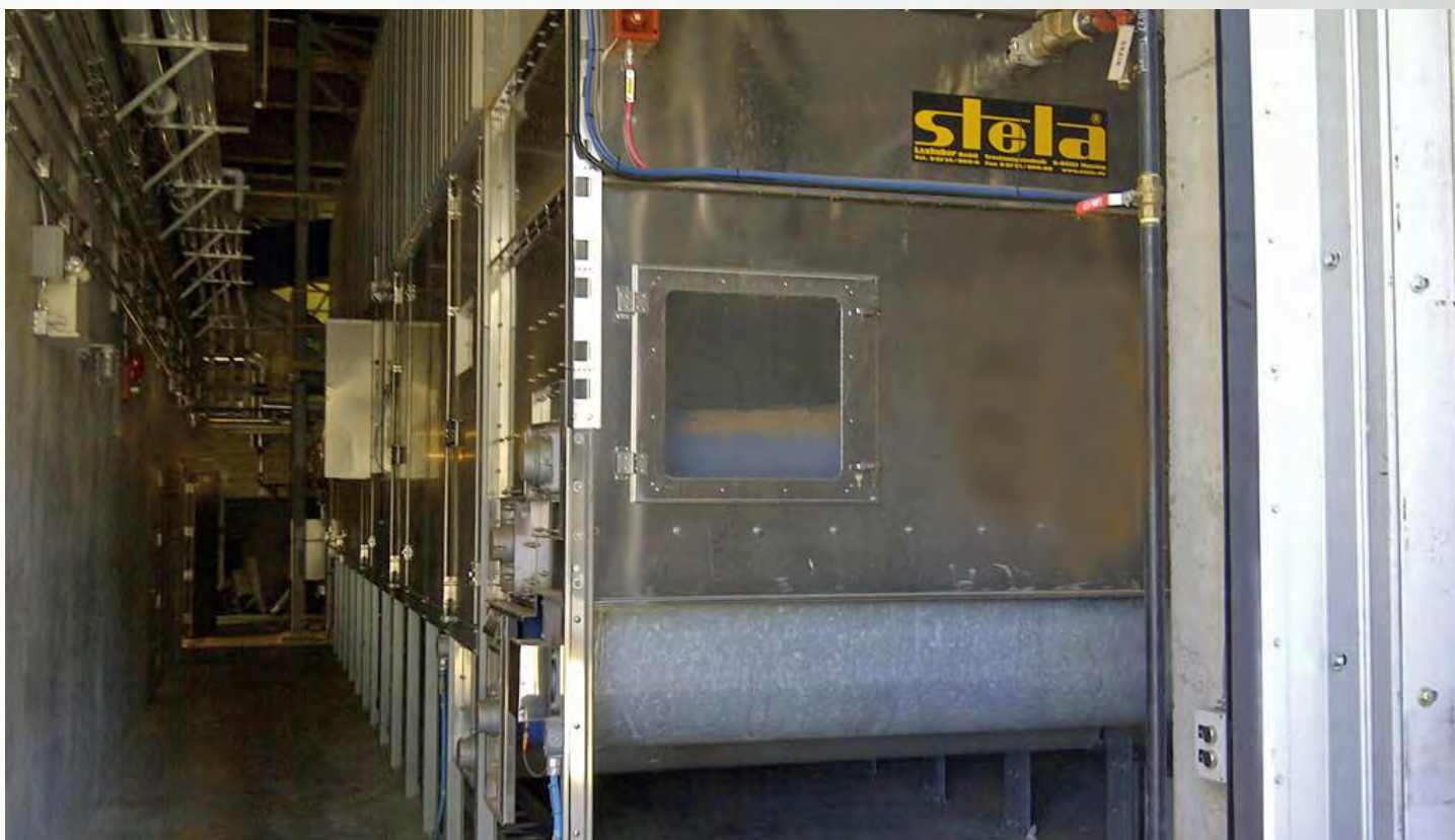
项目地：University of British Columbia, 加拿大 | 型号：BT 1/2700-14 | 安装年份：2012 干燥物料：木片、树皮 | 出料能力：约2.1吨/小时 | 降水区间：50% - 25%湿度
