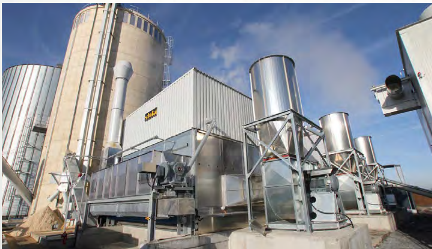
项目地：Holzindustrie Pauls, 比利时 | 型号：BT 1/6200-25.5 | 安装年份：2013 干燥物料：木屑 | 出料能力：约10.0吨/小时 | 降水区间：50% - 9%湿度
