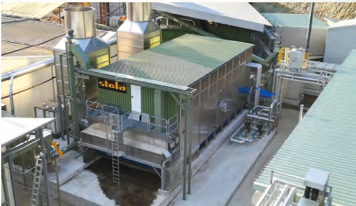
项目地：Toono Kosan, 日本 | 型号：BT 1/6200-13.5 | 安装年份：2018 干燥物料：木屑、湿磨料 | 出料能力：约4.0吨/小时 | 降水区间：50% - 10%湿度
