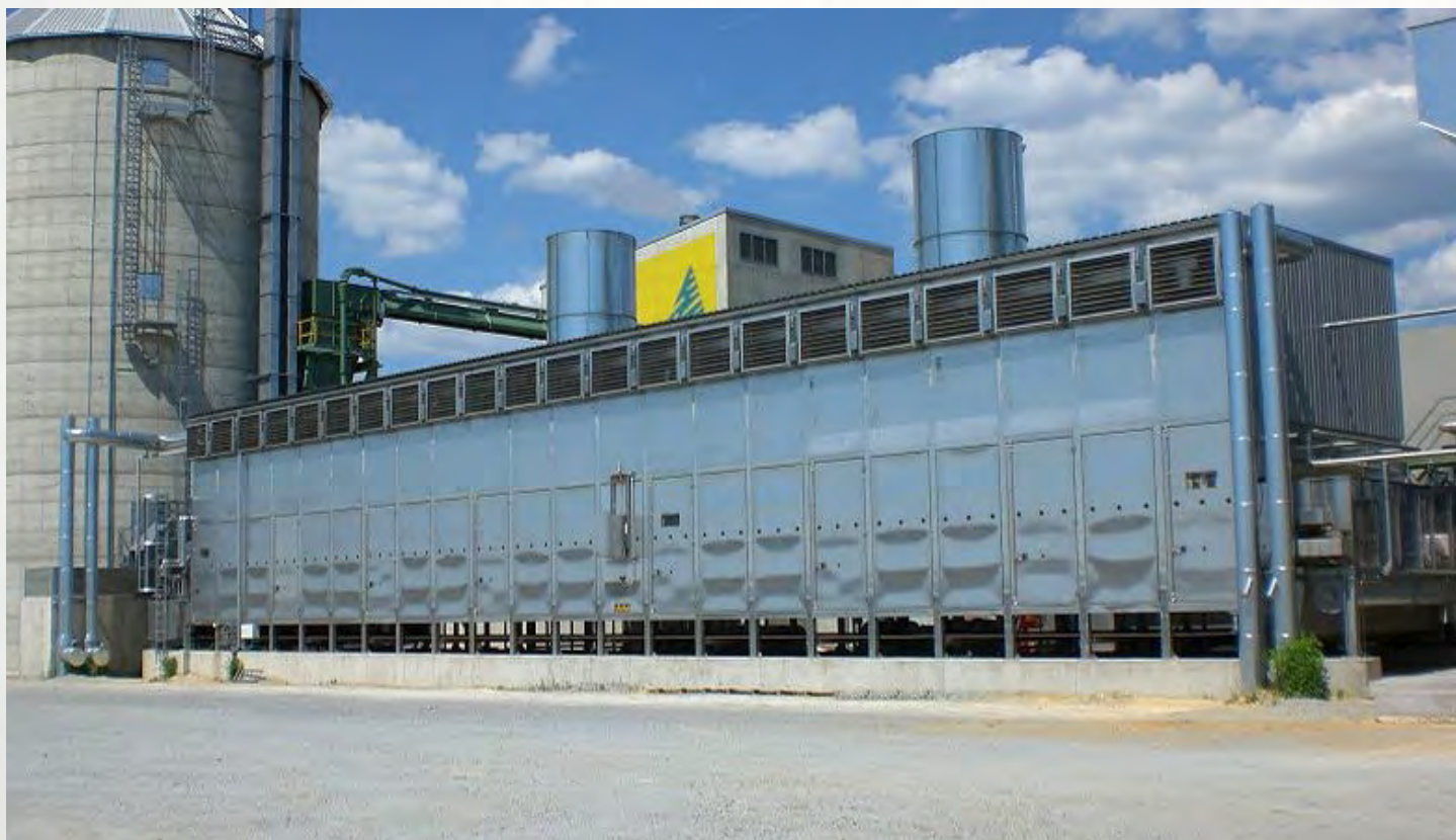
项目地：Sägewerk Schwaiger, 德国 | 型号：BT 1/6200-33 | 安装年份：2006 干燥物料：木屑 | 出料能力：约10.5吨/小时 | 降水区间：50% - 10%湿度
