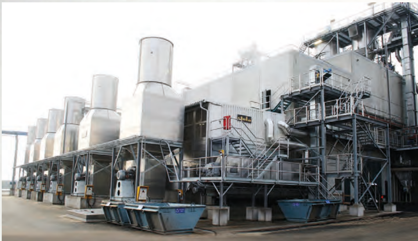
项目地：Södra Cell AB, 瑞典 | 型号：BT 1/6200-48 | 安装年份：2013 干燥物料：木屑 | 出料能力：约19.4吨/小时 | 降水区间：52% - 10%湿度
