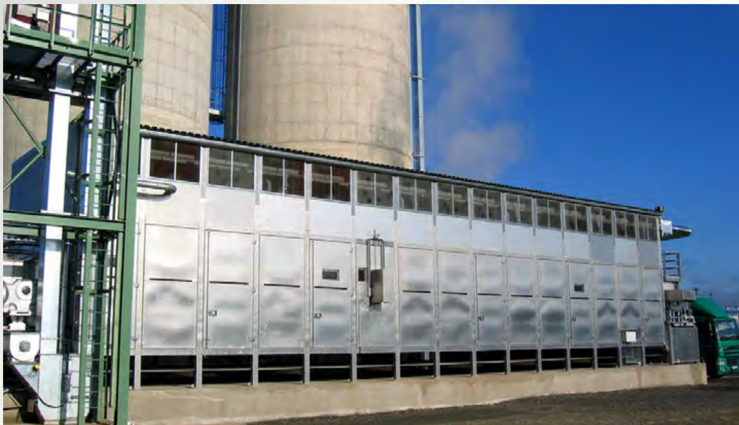
项目地：Mayr-Melnhof Holz Paskov s.r.o., 捷克 | 型号：BT 1/6200-22.5 | 安装年份：2007 干燥物料：木屑 | 出料能力：约8.5吨/小时 | 降水区间：50% - 10%湿度
