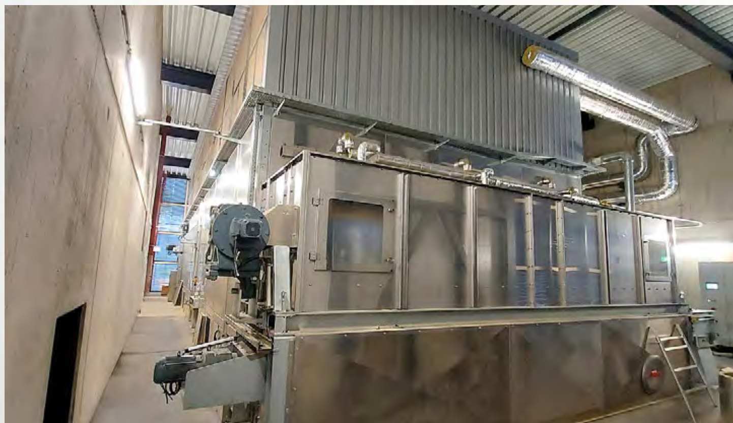
项目地：Rubner Holzindustrie GmbH，奥地利 | 型号：BT 1/6200-16.5 | 安装年份：2021 干燥物料：云杉木屑 | 出料能力：约6.7吨/小时 | 降水区间：45% - 10%湿度
