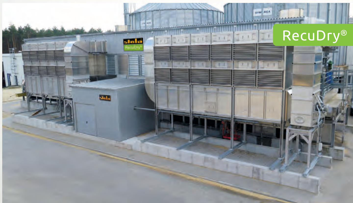
项目地：Ikea Industry, 波兰 | 型号：BTU RecuDry 1/6200-33 | 安装年份：2019 干燥物料：木屑 | 出料能力：约7.6吨/小时 | 降水区间：55% - 10%湿度
