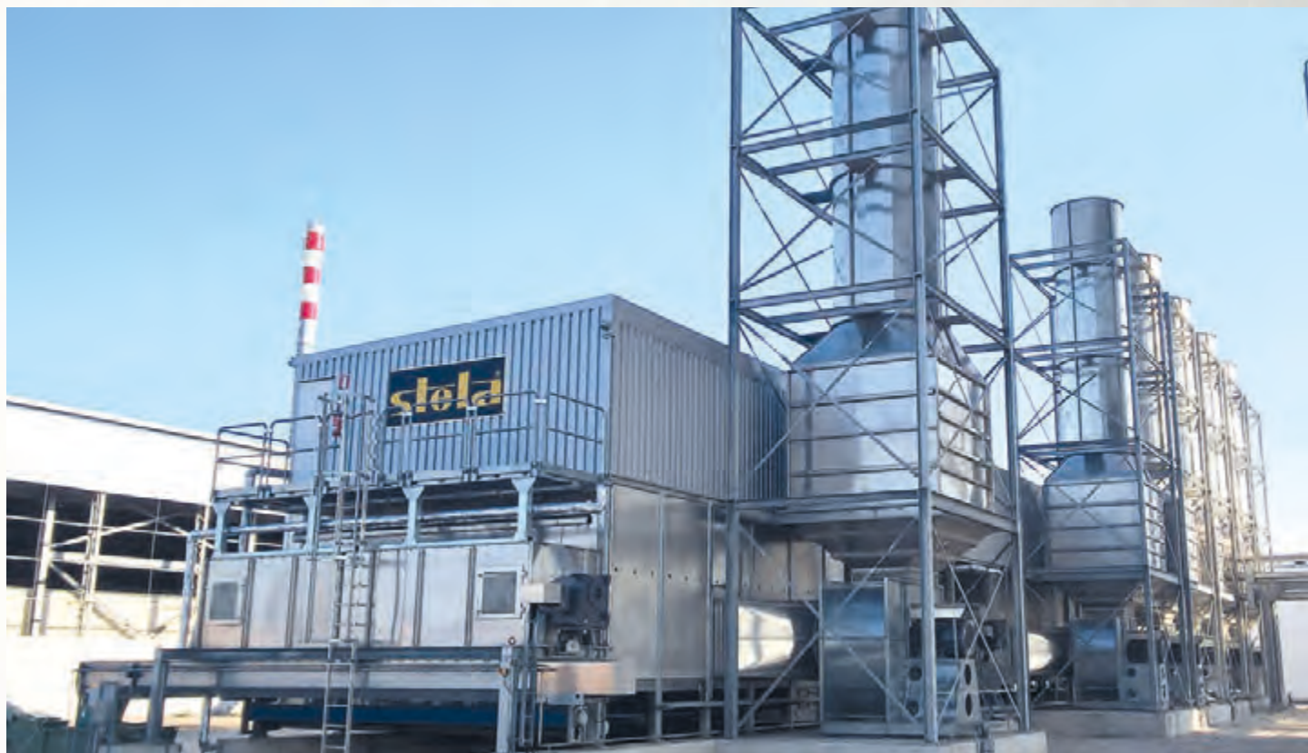
项目地：Enterra spa, 意大利 | 第1台：BT 1/6200-31.5 | 第2台：BT 1/6200-9 | 安装年份：2016 | 干燥物料：橄榄油渣 第1台出料能力：约15.7吨/小时 | 降水区间：55% - 38%湿度 | 第2台出料能力：4.0 吨/小时 | 降水区间：38% - 15%湿度
