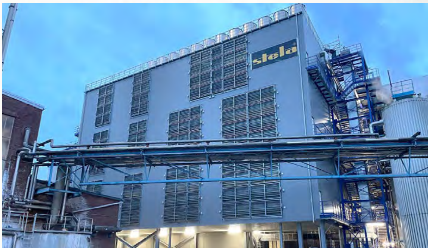
项目地：Pfeifer & Langen, 德国 | 型号：BT 3/6200-30 | 安装年份：2023 干燥物料：甜菜渣 | 出料能力：约40.0吨/小时 | 降水区间：70% - 55%湿度
