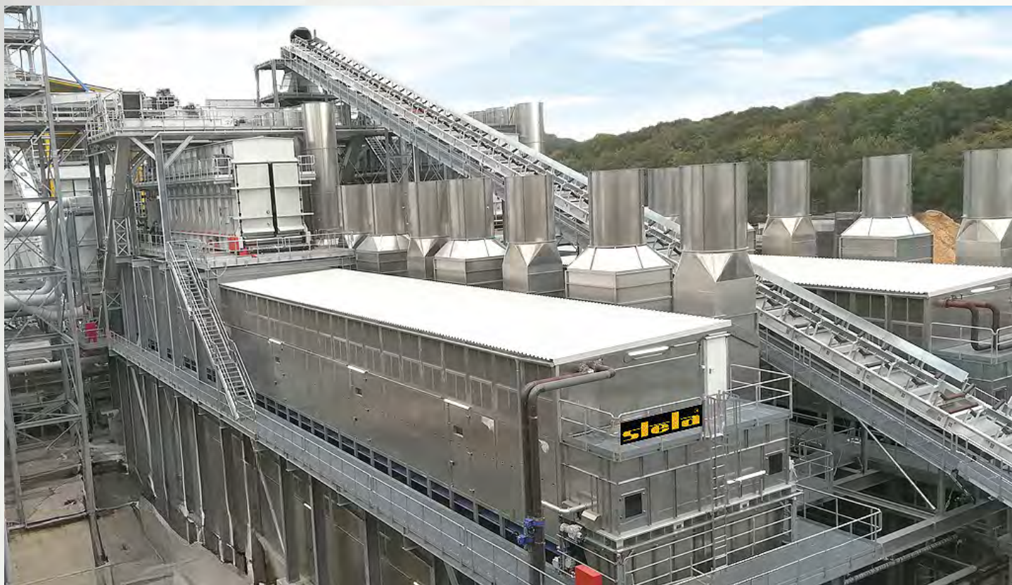
项目地：Kronospan S.A., 卢森堡 | 型号：2x BTU 2/6200-57 | 安装年份：2018 干燥物料：OSB定向刨花板 | 出料能力：约2x 30.6吨/小时 | 降水区间：100% - 2%含水率
