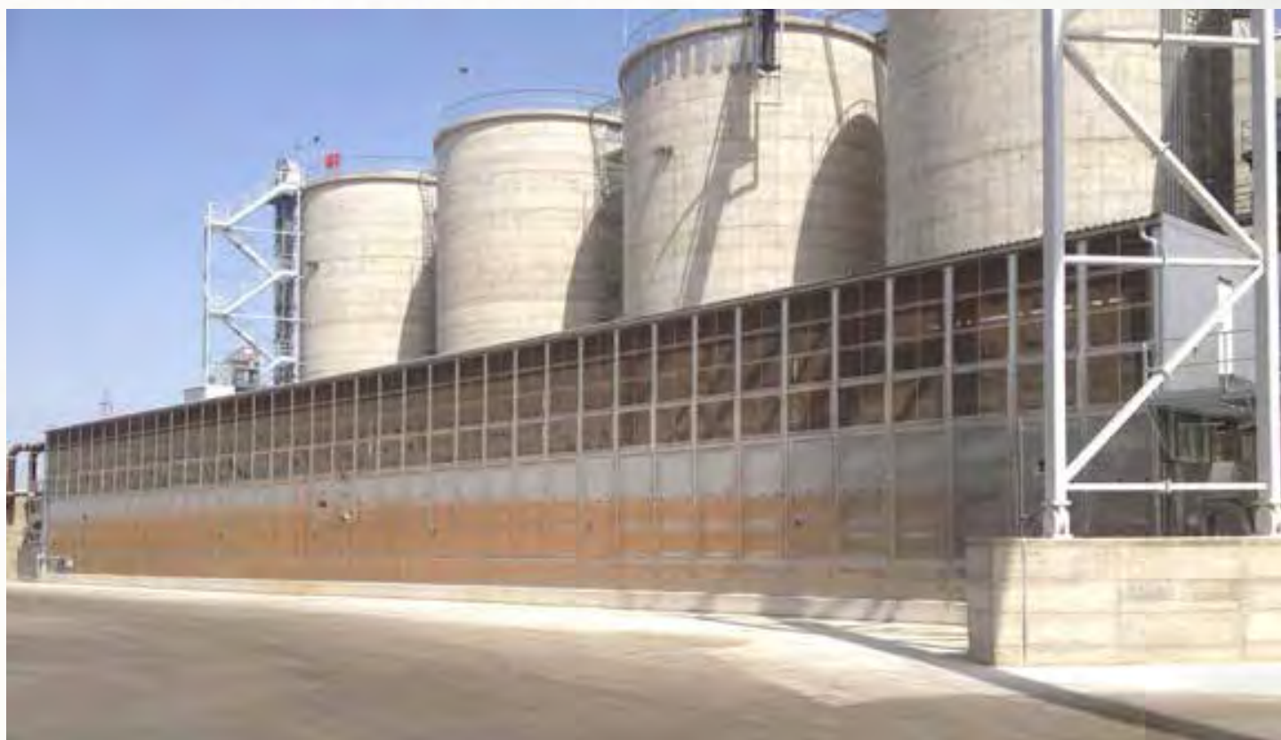
项目地：S.C. Holzindustrie Schweighofer, 罗马尼亚 | 型号：BT 1/6200-58.5 | 安装年份：2012 干燥物料：木屑 | 出料能力：约17.0吨/小时 | 降水区间：50% - 10%湿度
