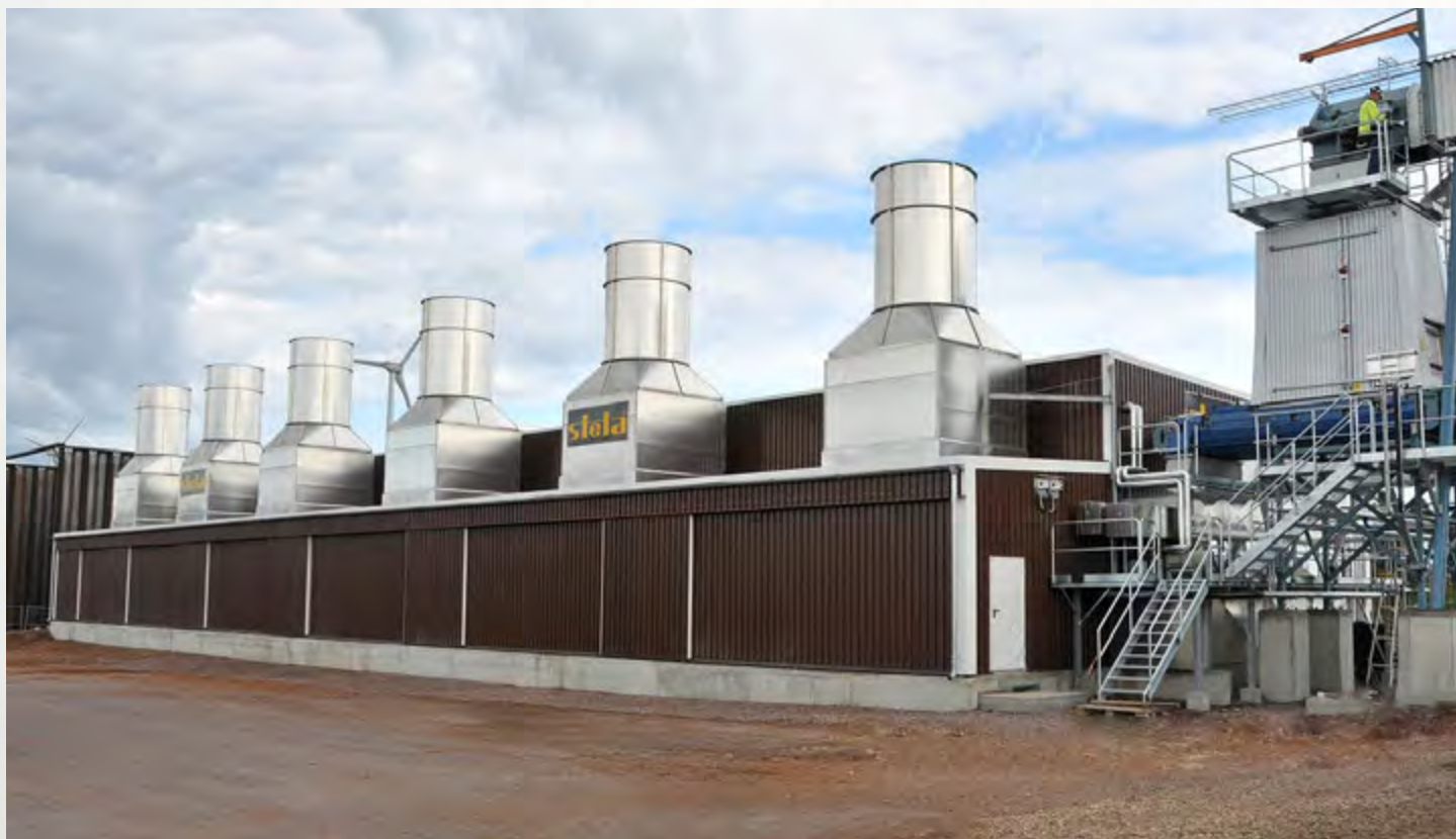
项目地：Södra Cell, 瑞典 | 型号：BT 1/6200-49.5 | 安装年份：2012 干燥物料：树皮 | 出料能力：约26.6吨/小时 | 降水区间：60% - 45%湿度
