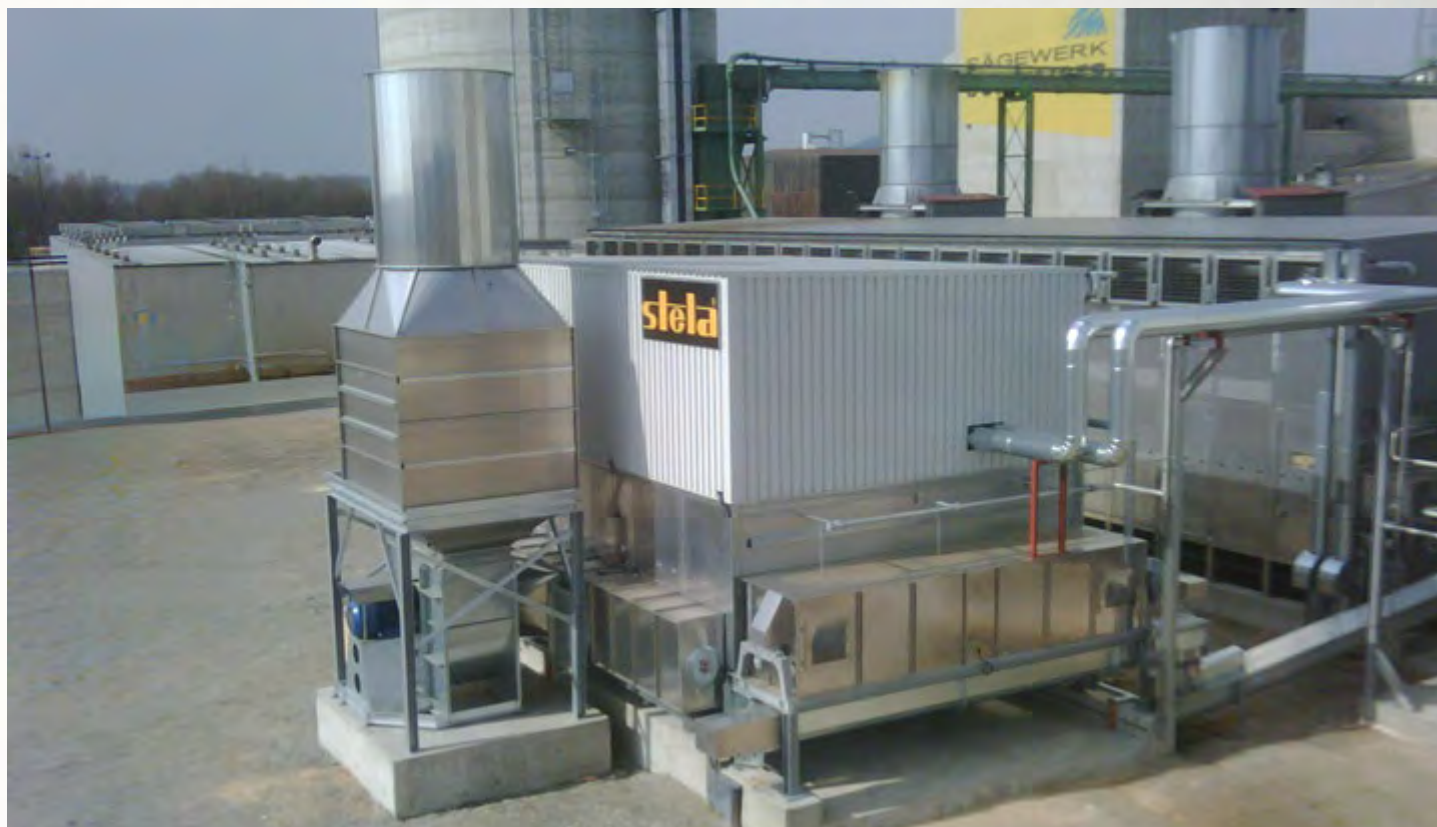
项目地：Sägewerk Schwaiger, 德国 | 型号：BT 1/6200-9 | 安装年份：2009 干燥物料：木屑 | 出料能力：约2.8吨/小时 | 降水区间：50% - 10%湿度
