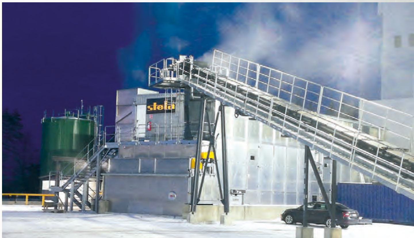
项目地：Technip Benelux B.V., 芬兰 | 型号：BT 1/6200-22.5 | 安装年份：2020 干燥物料：木屑、刨花 | 出料能力：约6.0吨/小时 | 降水区间：50% - 3%湿度
