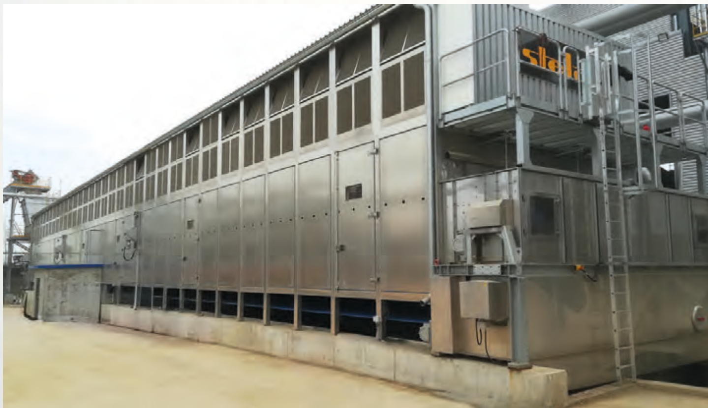
项目地：山东俏家装饰, 中国 | 型号：BTU 1/6200-49.5 | 安装年份：2018 干燥物料：木屑 | 出料能力：约15.7吨/小时 | 降水区间：80% - 2%含水率
