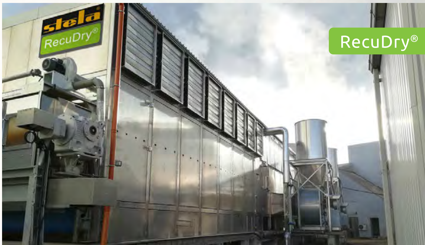
项目地：SIA Baltic Block, 拉脱维亚 | 型号：BTU RecuDry 1/6200-28.5 | 安装年份：2017 干燥物料：木屑 | 出料能力：约7.5吨/小时 | 降水区间：50% - 2%湿度
