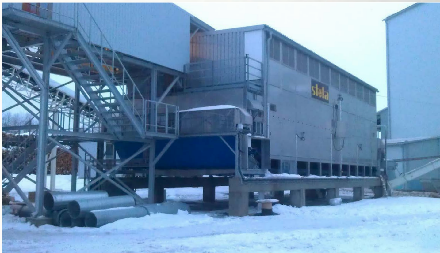
项目地：Aboltina buvuznemums AG, 拉脱维亚 | 型号：BT 1/6200-16.5 | 安装年份：2011 干燥物料：木屑 | 出料能力：约3.6吨/小时 | 降水区间：50% - 3%湿度
