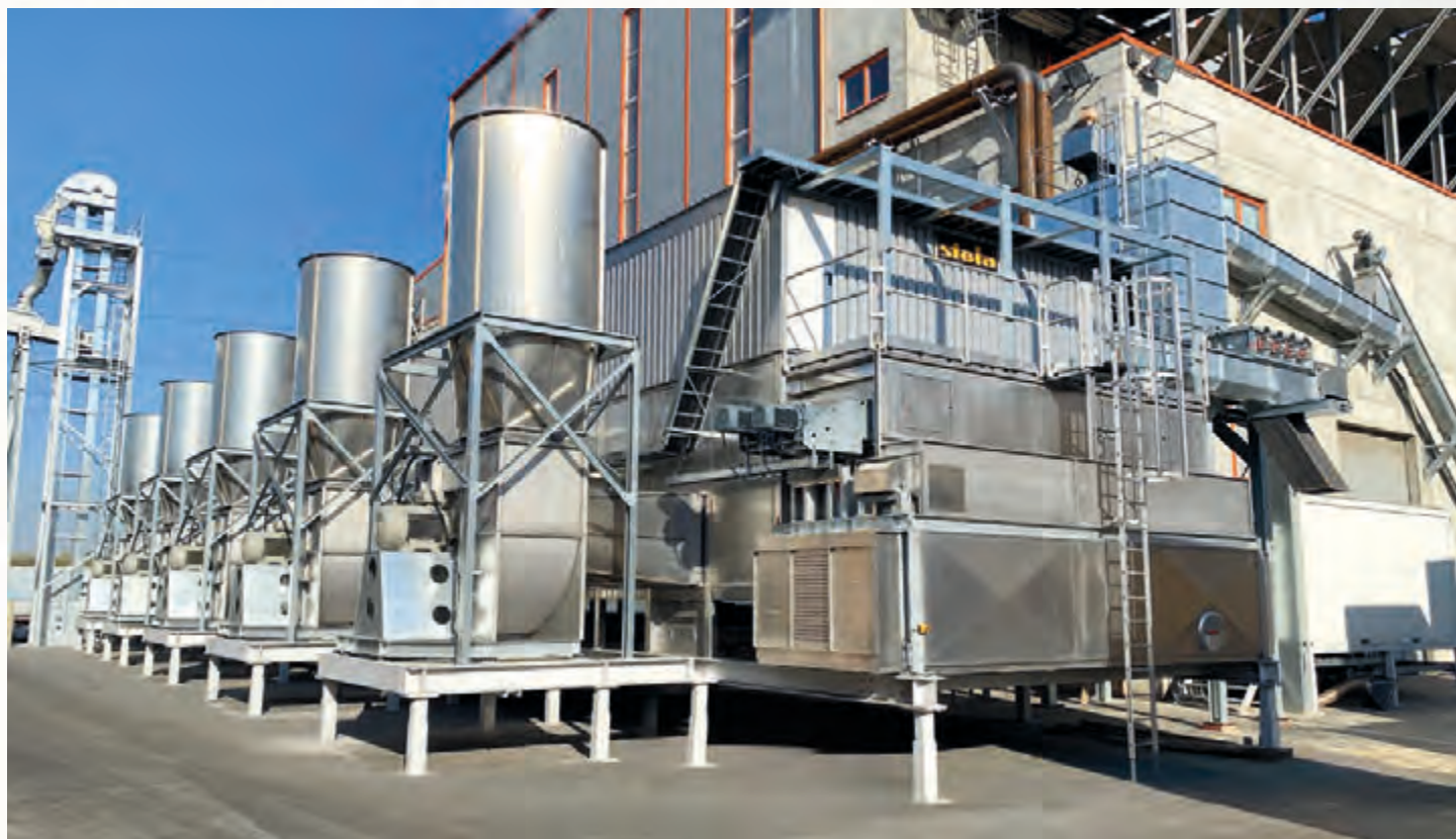
项目地：Sebes II, 罗马尼亚 | 型号：BT 1/6200-37.5 | 安装年份：2020 干燥物料：木屑 | 出料能力：约12.7吨/小时 | 降水区间：50% - 10%湿度
