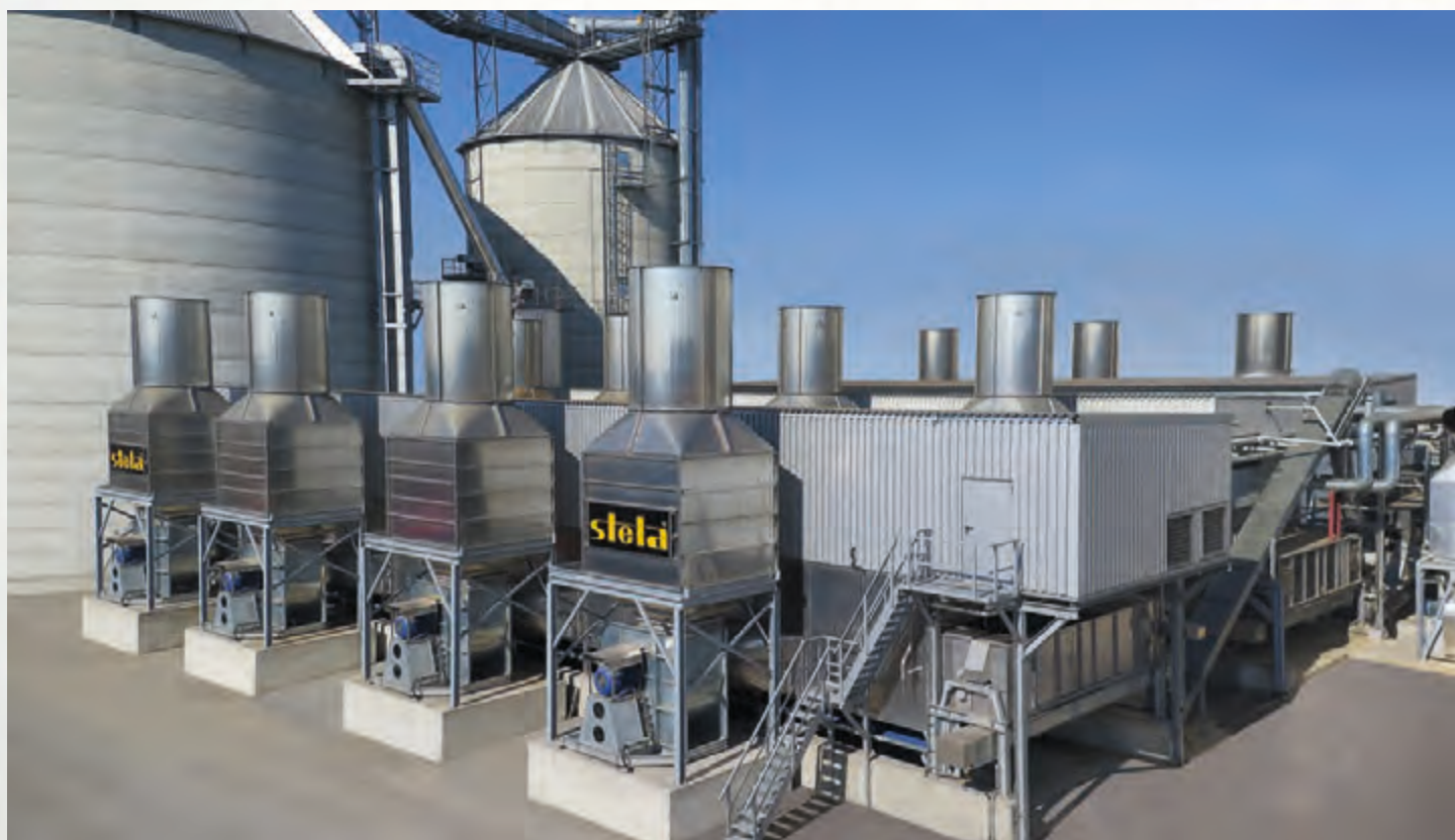
项目地：Sägewerk Schwaiger, 德国 | 型号：BT 1/6200-33 | 安装年份：2014 干燥物料：木屑 | 出料能力：约10.5吨/小时 | 降水区间：50% -10%湿度
