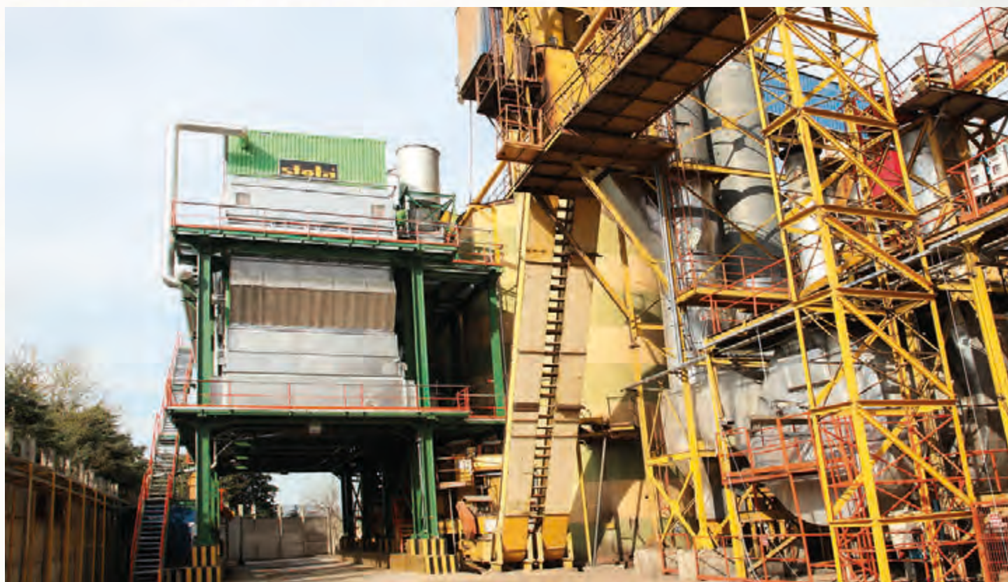
项目地：Starwood AS, 土耳其 | 型号：BT 2/6200-22.5 | 安装年份：2018 干燥物料：木片 | 出料能力：约12.8吨/小时 | 降水区间：100% - 1.5%含水率
