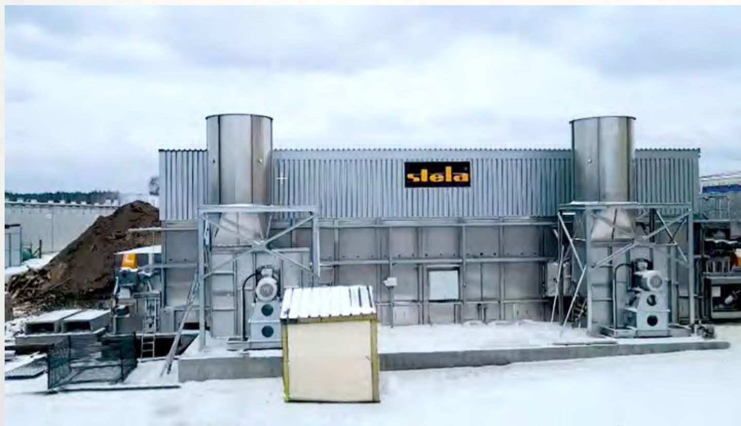
项目地：Vostok Ressources, 俄罗斯 | 型号：BT 1/6200-19.5 | 安装年份：2021 干燥物料：木屑 | 出料能力：约6.0吨/小时 | 降水区间：55% - 10%湿度
