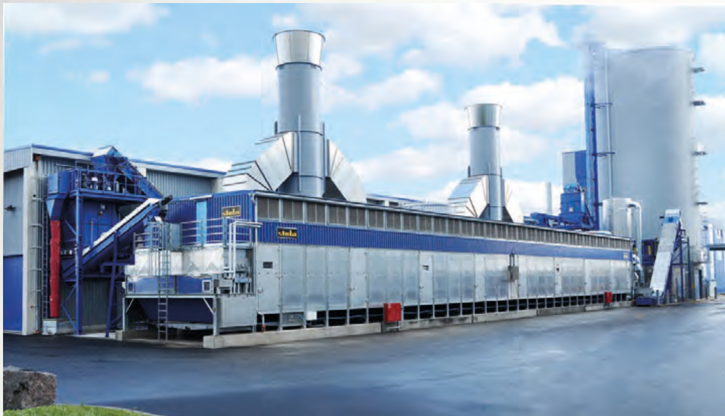
项目地：NRW Pellets GmbH, 德国 | 型号：BT 1/6200-48 | 安装年份：2010 干燥物料：木屑 | 出料能力：约17.5吨/小时 | 降水区间：50% - 10%湿度
