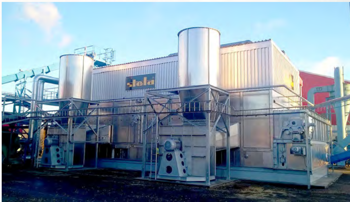
项目地：„SETLES“ LLC, 俄罗斯 | 型号：BT 1/6200-15 | 安装年份：2017 干燥物料：木屑 | 出料能力：约4.5吨/小时 | 降水区间：55% - 10%湿度
