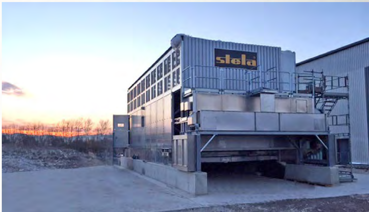
项目地：North West Biomass Limited, 英国 | 型号：BT 1/6200-15 | 安装年份：2017 干燥物料：湿磨木片 | 出料能力：约5.1吨/小时 | 降水区间：48% - 10%湿度
