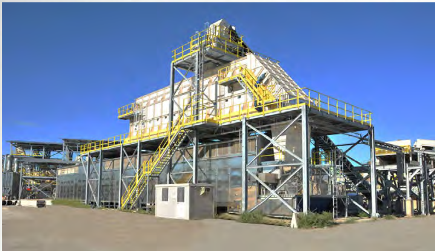
项目地：I-PAN, 意大利 | 型号：BT 1/6200-43.5 | 安装年份：2012 干燥物料：OSB定向刨花板 | 出料能力：约9.6吨/小时 | 降水区间：56.8% - 3%湿度
