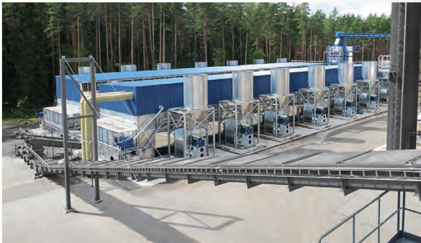
项目地：SIA Graanul Pellets, 拉脱维亚 | 型号：BT 1/6200-49.5 | 安装年份：2014 干燥物料：木屑 | 出料能力：约14.1吨/小时 | 降水区间：50% - 10%湿度
