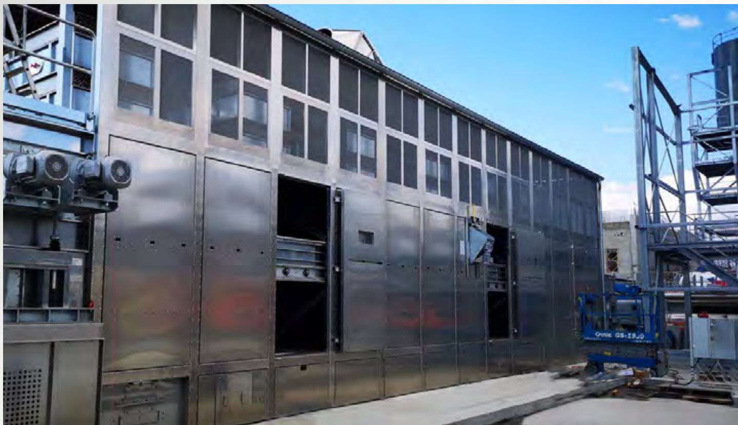
项目地：CEA, 法国 | 型号：BT 1/6200-19.5 | 安装年份：2019 干燥物料：木屑 | 出料能力：约13.9吨/小时 | 降水区间：45% - 30%湿度
