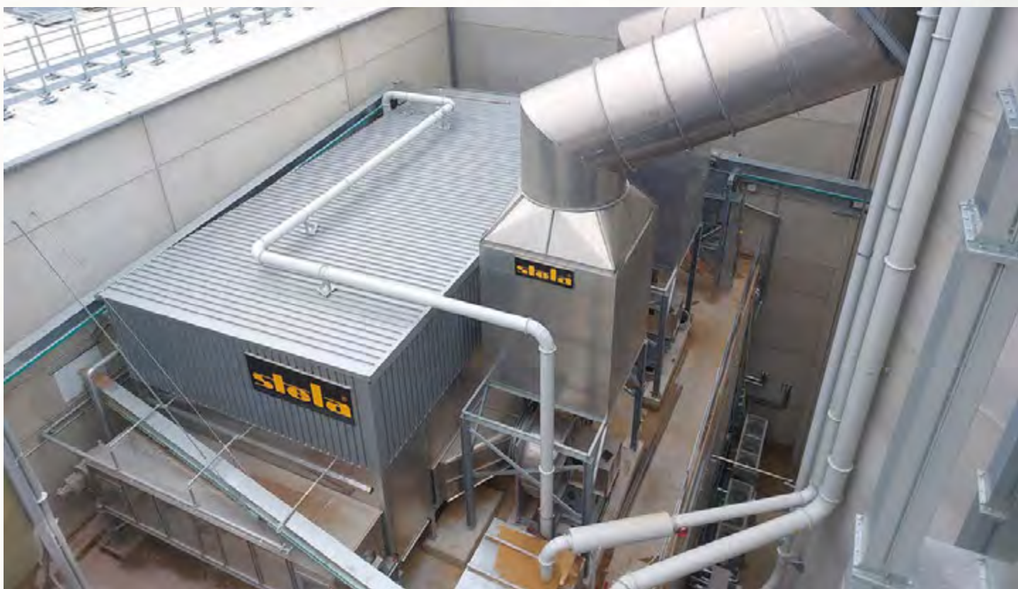
项目地：Holzwerk Gebr. Schneider, 德国 | 型号：BT 1/6200-13.5 | 安装年份：2022 干燥物料：木屑 | 出料能力：约4.5吨/小时 | 降水区间：50% - 10%湿度
